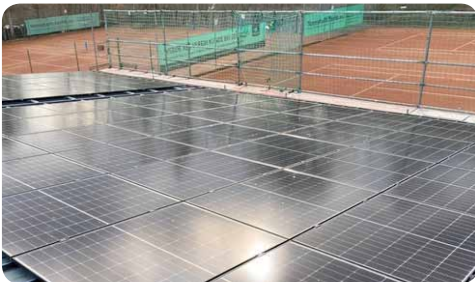
Die neue PV-Anlage des twe
